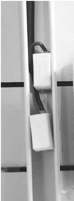
Aansluiting in kabelkanaal
