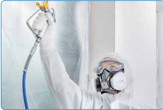
Utilisation du masque lors des travaux de peinture Airless sur paroi ou façade
